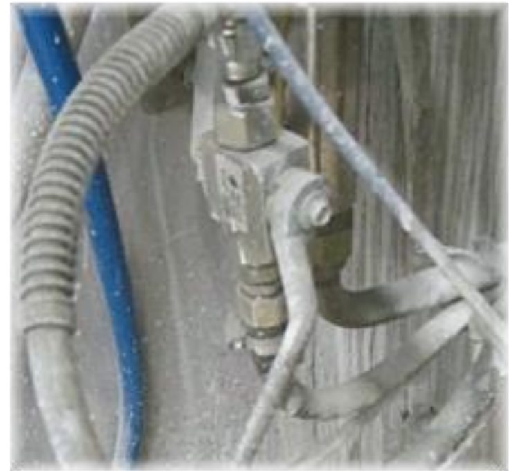
Kuva 30. Palautusputken kierrätysventtiili avattuna
